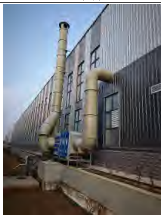
废气处理设施
