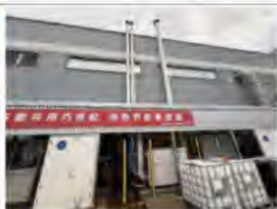
热水锅炉排气筒 (DA001-DA003)
